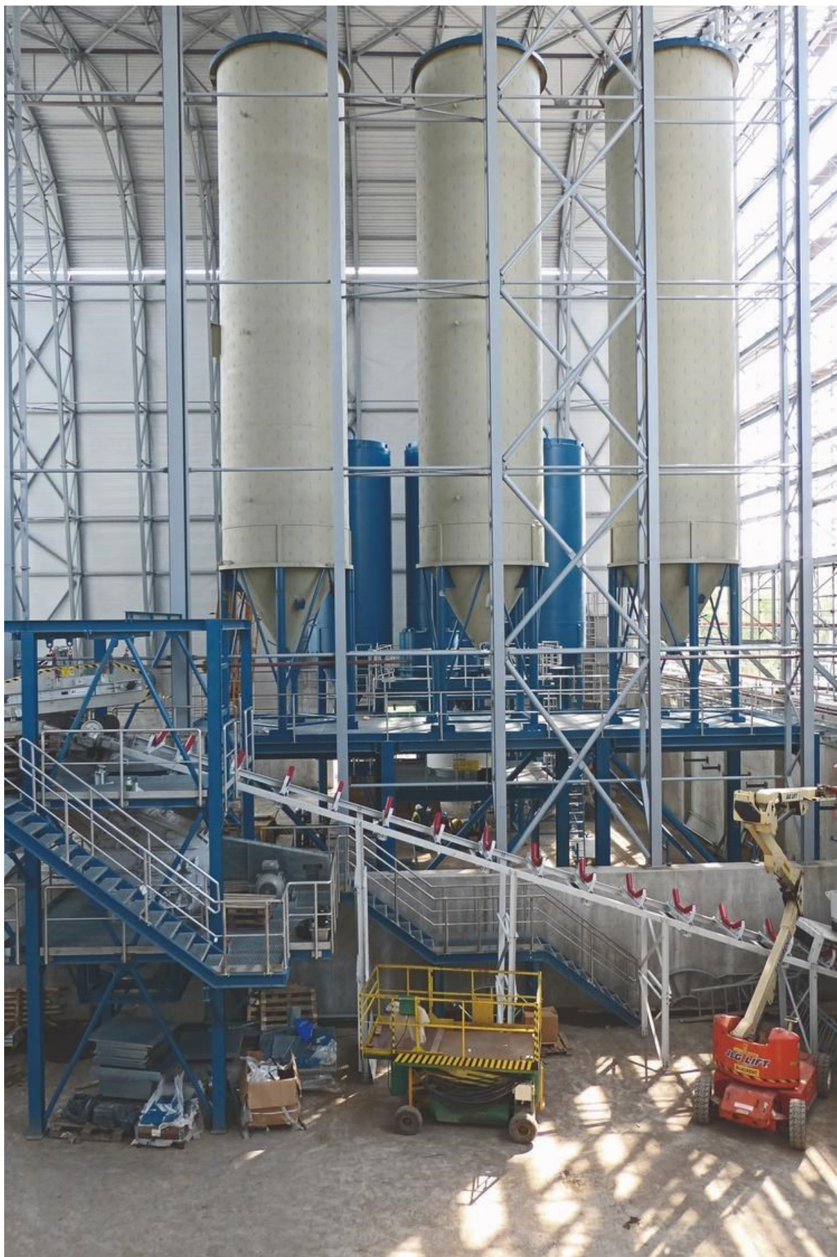
G/ Wnętrze hali budynku gospodarki pozostałościami procesowymi (fot. KHK S.A. Kraków).
