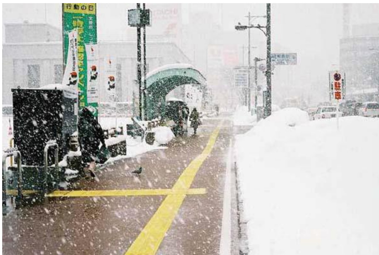
Rys. 9 Instalacja topnienia śniegu na chodniku w miejscowości Aomori, Japonia [26]
