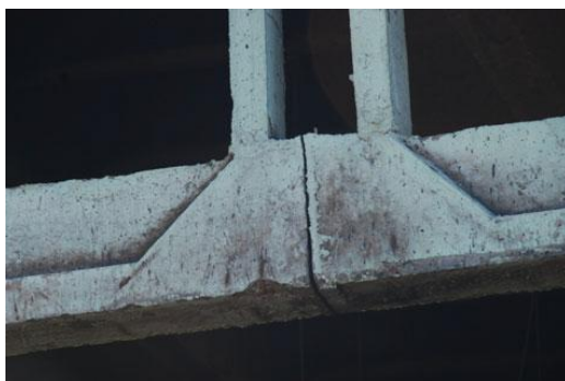
Rys. 1. Trwale otwarty styk w pasie dolnym dźwigara kablobetonowego. A1
