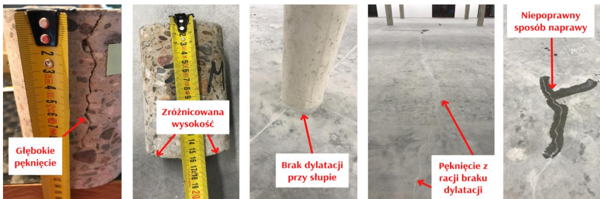
Rysunek 46. Przykładowe wady i uszkodzenia występujące w kompozytach cementowych stosowanych na warstwę wierzchnią podłóg (zdjęcia własne autora)
