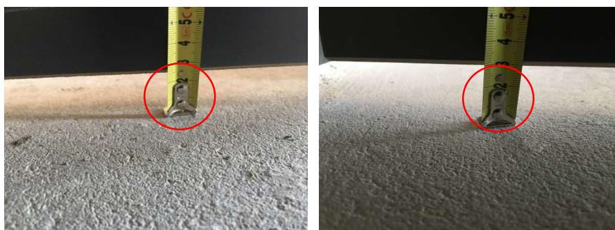
Rys. 15 Przykład usterki stolarki drzwiowej polegająca na braku regulacji i nierównej szczelinie pomiędzy drzwiami wejściowymi a podłogą. [Źródło własne]
