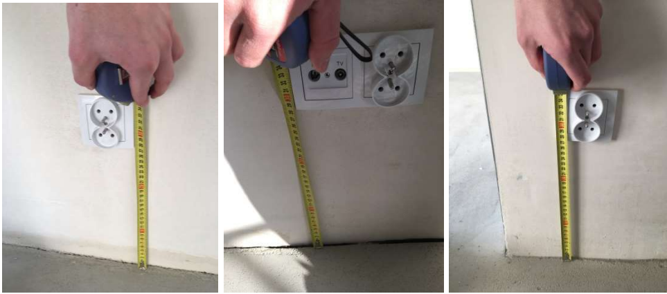
Rys. 17 Przykład usterki polegającej na zamontowaniu gniazdek elektrycznych na różnych wysokościach w tym samym pomieszczeniu. [Źródło własne]
