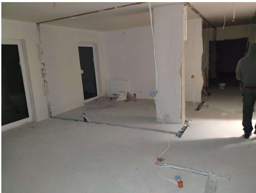
Rys. 22 Ilustracja przedstawiająca stan konstrukcji nośnej budynku po wykonaniu zmian lokatorskich [Źródło własne]
