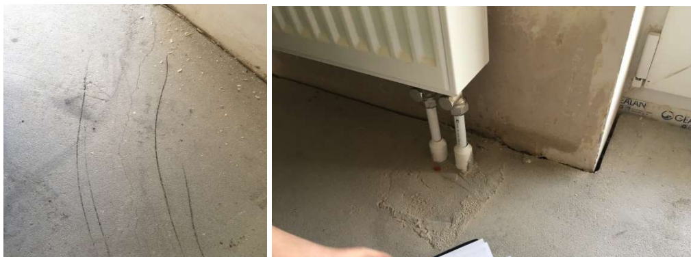
Rys. 11 Przykład usterki polegającej na pęknięciu posadzki i braku równości jej powierzchni. [Źródło własne]
