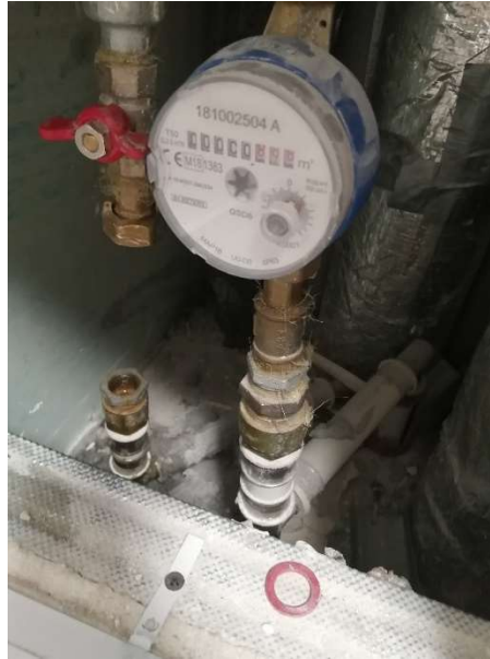
Rys. 19 Przykład usterki polegającej na przecieku spowodowanym niedostatecznie wkręconym pół śrubunkiem wodomierzowym w redukcję. Źródło własne
