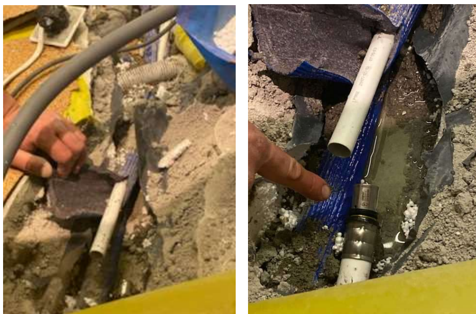
Rys. 24 Ilustracja przedstawiająca usterkę instalacji wody zimnej po ingerencji w warstwy posadzki jastrychowej [Źródło własne]
