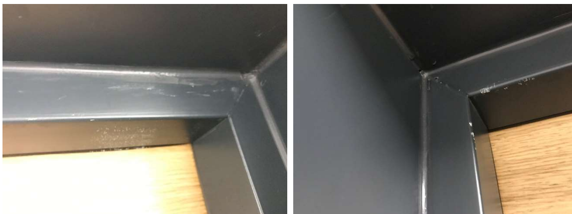
Rys. 16 Przykład usterki polegającej na uszkodzeniu mechanicznym stolarki drzwiowej i nie estetycznym wykonaniu silikonów. Źródło własne
