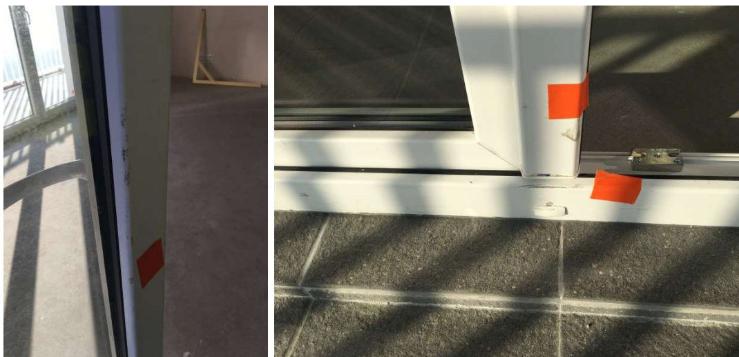
Rys. 14 Przykład usterki drzwi balkonowych polegające na uszkodzeniach mechanicznych na słupku ruchomym i na ramach od zewnątrz. [Źródło własne]
