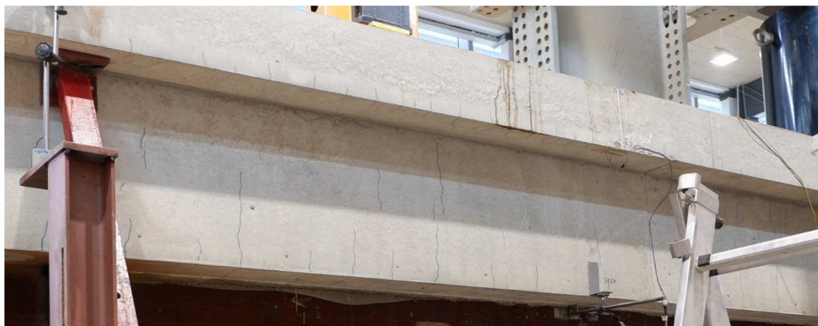
Rys. 6.30 Oznaczenie rys spowodowanych skurczem przed przystąpieniem do obciążenia (S2-300)
