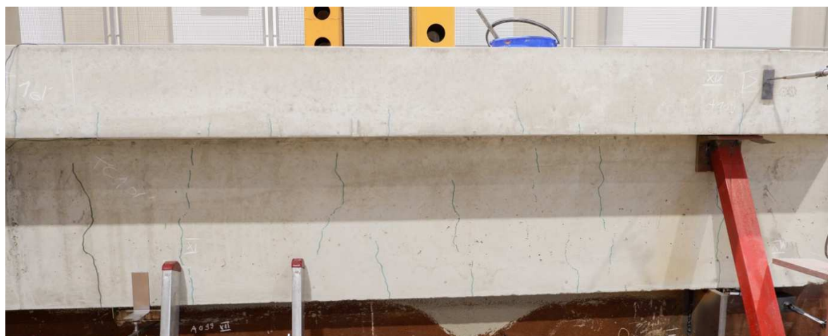
Rys. 6.23 Oznaczenie rys spowodowanych skurczem przed przystąpieniem do obciążenia (S1-200)
