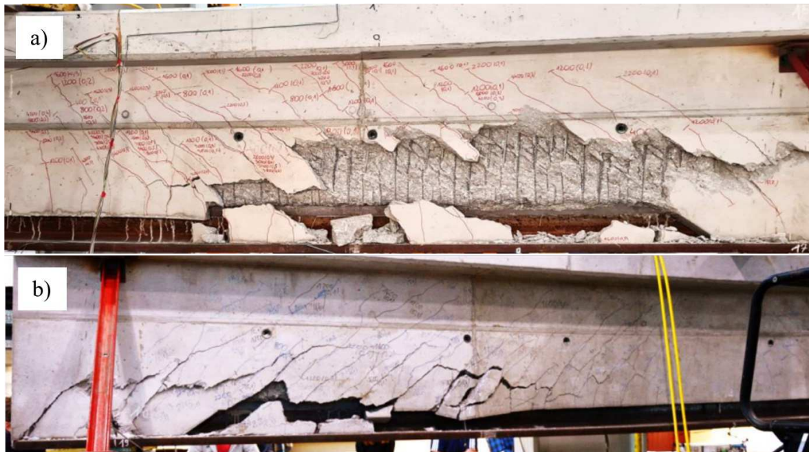
Rys. 6.5 Zniszczony środnik belki po jej powtórnych obciążeniu w celu ustalenia nośności rezydualnej a) po stronie inicjacji zniszczenia b) po stronie, która uległa zniszczeniu dopiero po powtórnych obciążeniu.
