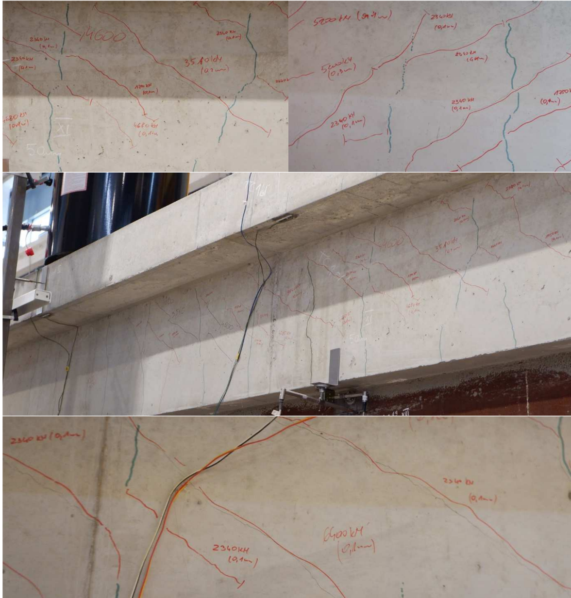
Rys. 6.28 Układ rys ukośnych na śródniku w trzecim etapie obciążenia (S1-200)
