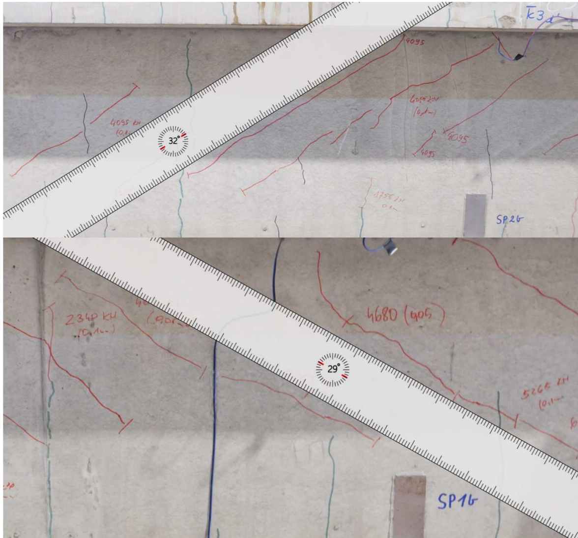
Rys. 6.33 Układ rys ukośnych na środniku w trzecim etapie obciążenia (S2-300)
