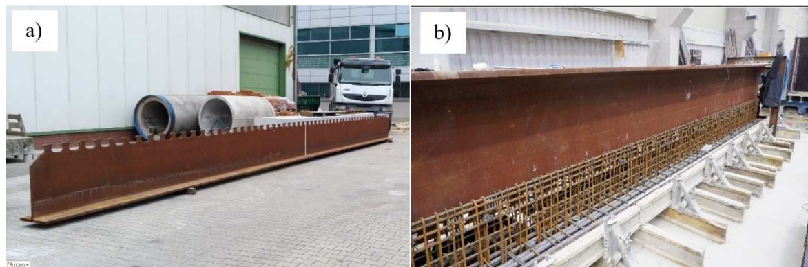
Rys. 6.16 Wykonanie belek S1-200 i S2-300 w zakładzie prefabrykacji a) kształtownik stalowy przed rozcięciem na elementy S1-200 i S2-300, b) belka S2-300 w czasie montażu zbrojenia
