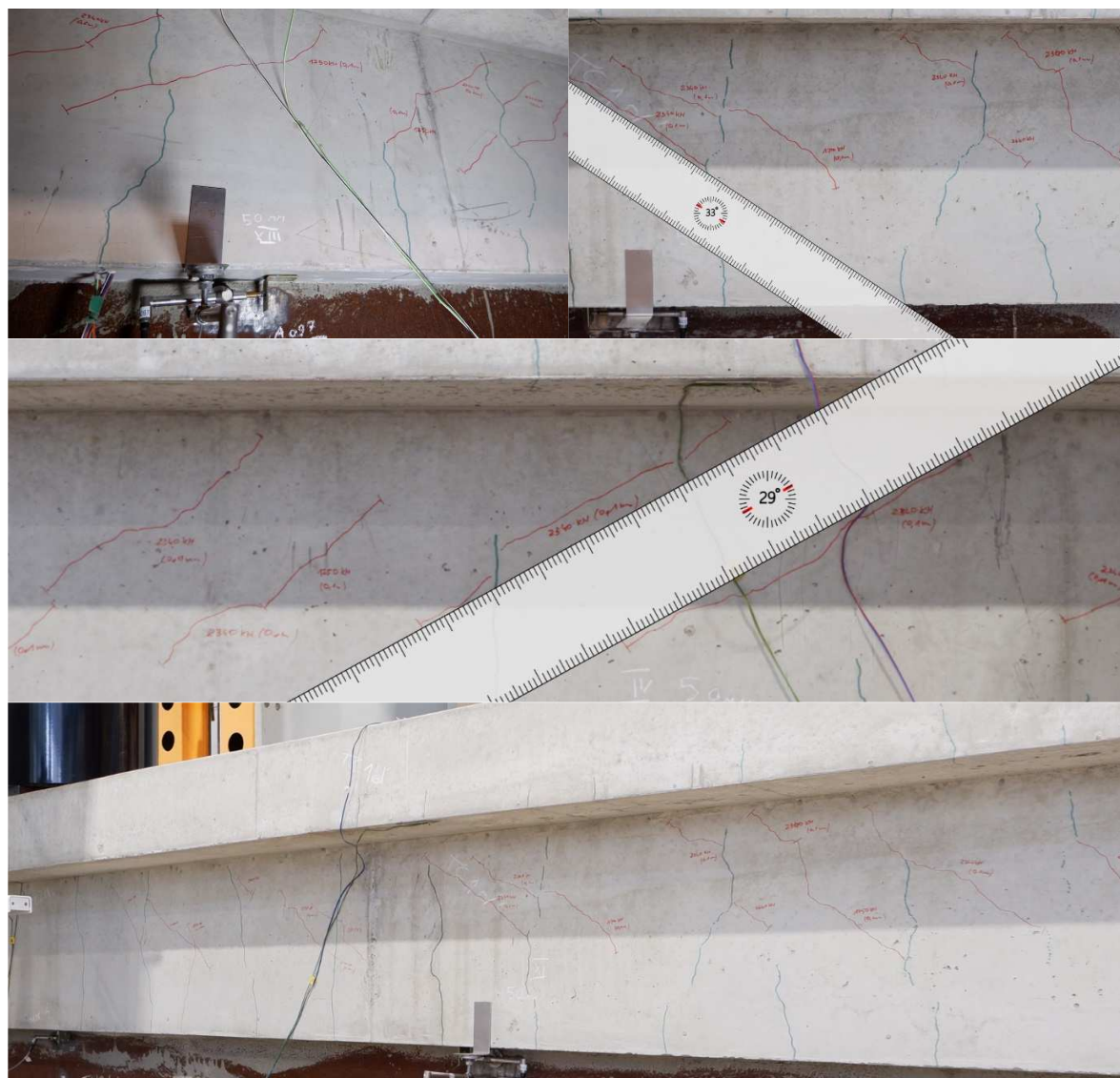
Rys. 6.27 Obraz zarysowania środka przy obciążeniu 2340 kN (S1-200)
