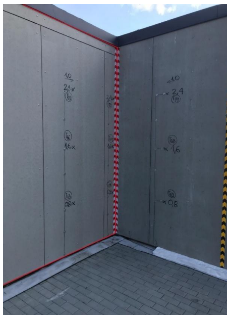
Rys. 4.15. Elewacja wentylowana na budynku modelowym – seria badań F z oznaczoną lokalizacją z okładzinami z płyt włóknisto-cementowych
