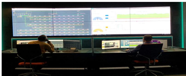
Rysunek 2. Widok na centralny system monitoringu i sterowania EOC.
