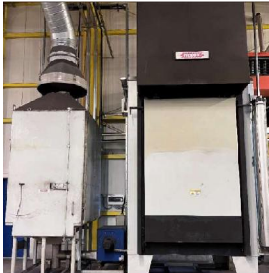
Rys. 43. Piec do obróbki cieplnej (po prawej) oraz komora do kontrolowanego chłodzenia (po lewej)
