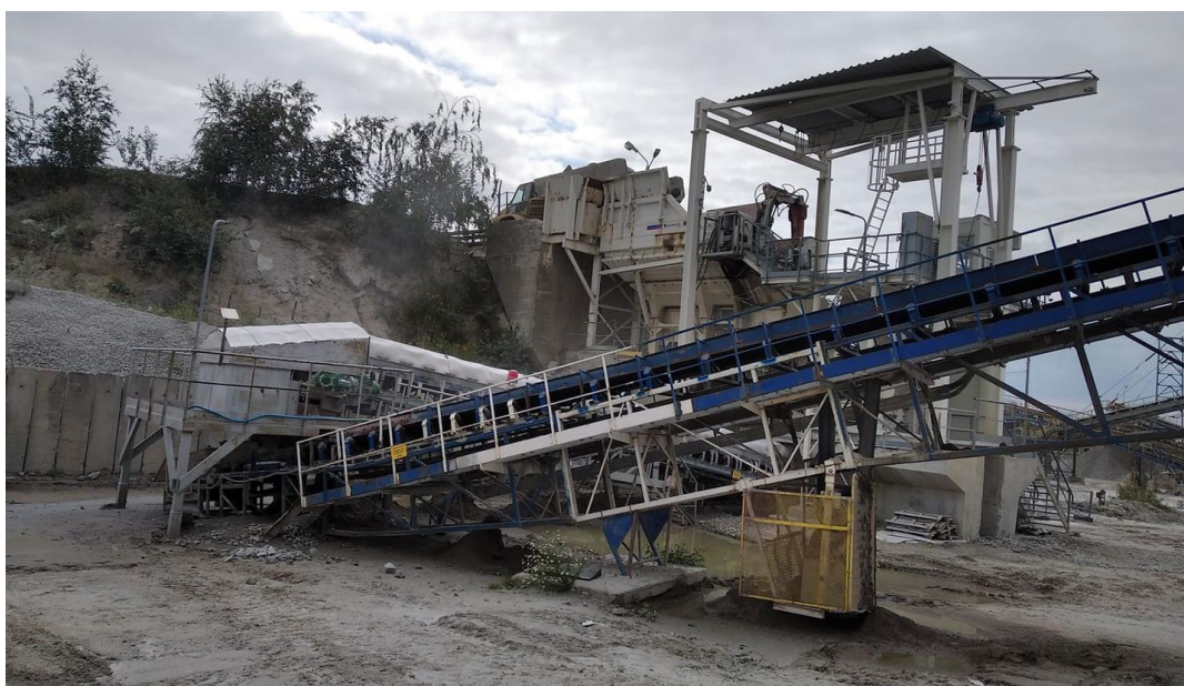
Rysunek 53. Przenośnik PT-1000/60 – widok stacji zwrotnej, przesypu oraz grawitacyjnego urządzenia napinającego (zdjęcie własne).
