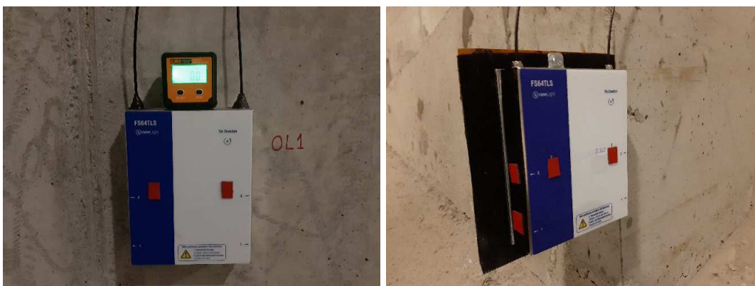
Rys. 16. Czujniki pochylenia w pkt OL1 i OX1 zainstalowane wewnątrz przęsła nurtowego
