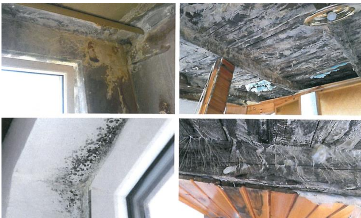
Rys. 3.4 - Skutki kondensacji wilgoci w miejscach konstrukcyjnych [31]
