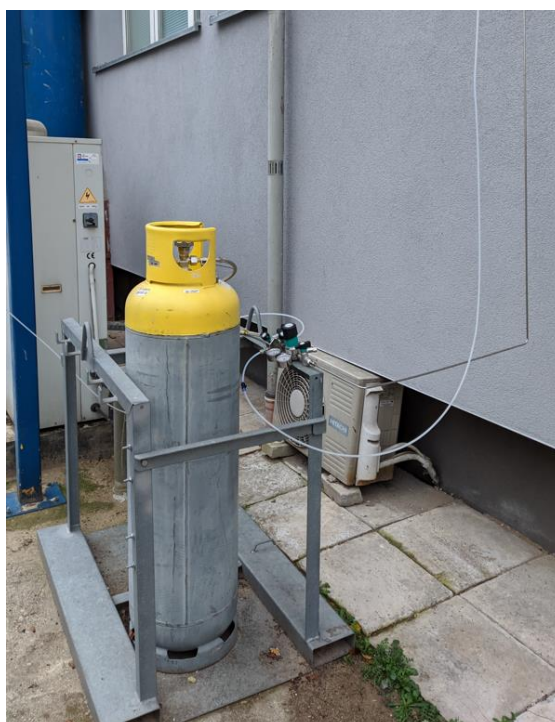
Rys. 18. Stacja rozprężania amoniaku wraz z linią doprowadzającą gaz do laboratorium
