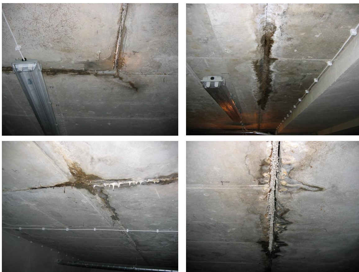
Rys. 9.2. Stan konstrukcji przed naprawą z widocznymi uszkodzeniami w postaci wycieków wody z przerwy dylatacyjnej.
