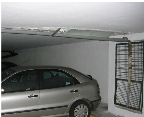
Rys. 3.4. Widok zniszczeń elementów konstrukcji stropu przy przerwie dylatacyjnej, prowizorycznych odwodnień, odpływu przeciekającej wody z przerwy dylatacyjnej nad zaparkowanym samochodem.
