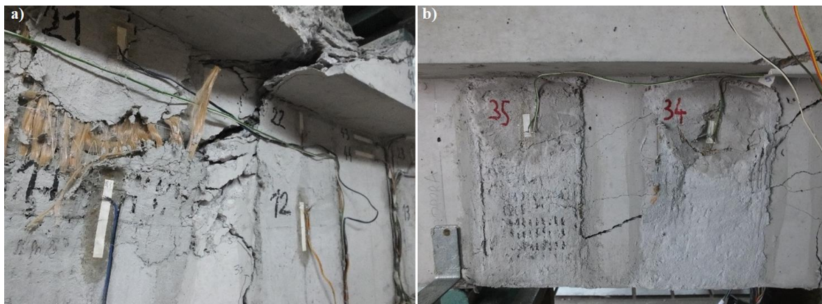
Rys. 4.34. Zniszczenie belek B_WS: a) zarysowanie zakotwienia i wyrwanie włókien PBO, b) zarysowanie zewnętrznej zaprawy świadczącej o poślizgu włókien na zaprawie
