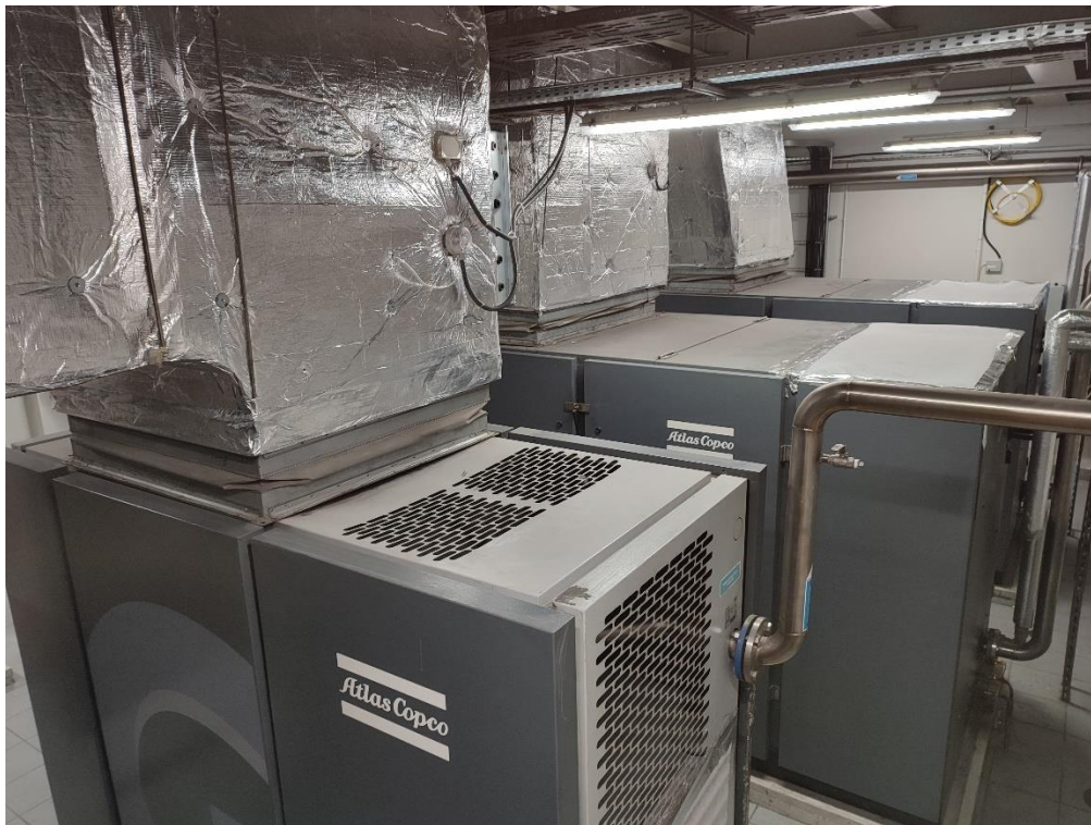
Rys. 80. Sprężarki podłączone do instalacji odprowadzania ciepła odpadowego z układu chłodzenia.
