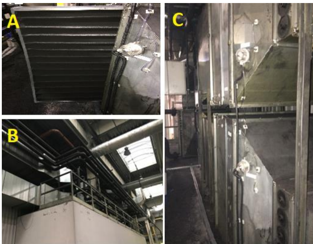
Rys. 14. Zdjęcia przedstawiające układ wymiennika ciepła powietrze/woda: A) zabrudzenie filtra powietrza po tygodniu eksploatacji, B) widok antresoli z zainstalowanym wymiennikiem ciepła z poziomu hali produkcyjnej, C) widok obudowy wymiennika ciepła.
