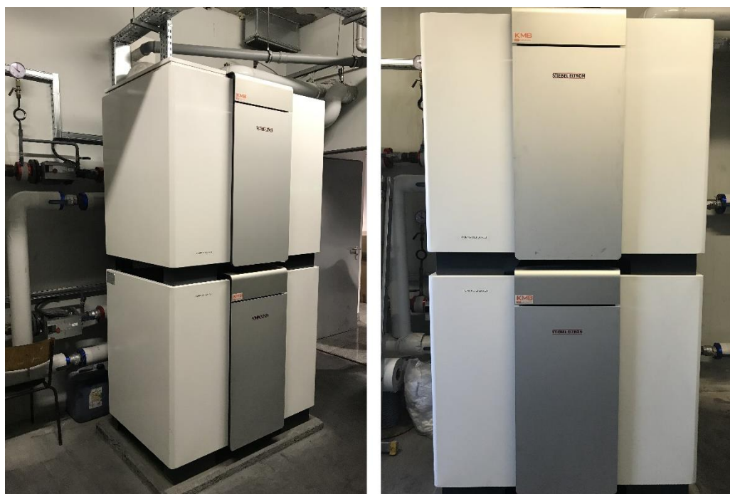
Rys. 18. Pompy ciepła Steibel Eltron WPF 66 zainstalowane w kotłowni.
