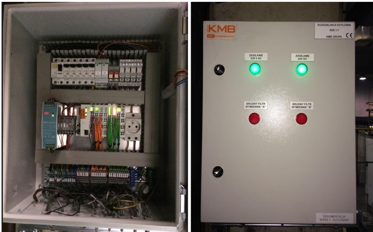
Rys. 16. Zdjęcia rozdzielnic RZS 1.1. (automatyka wymienników ciepła)
