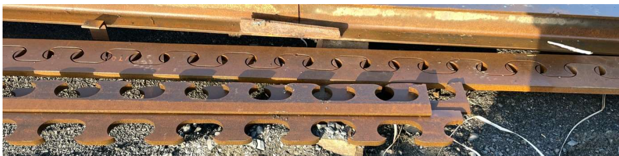
Rys. 15 Przygotowane "grzebienie" o grubości rzędu 30 mm do dospawania do cieńszych środków dźwigarów hybrydowych. Budowa drogi S3 (odcinek Troszyn – Świnoujście)
