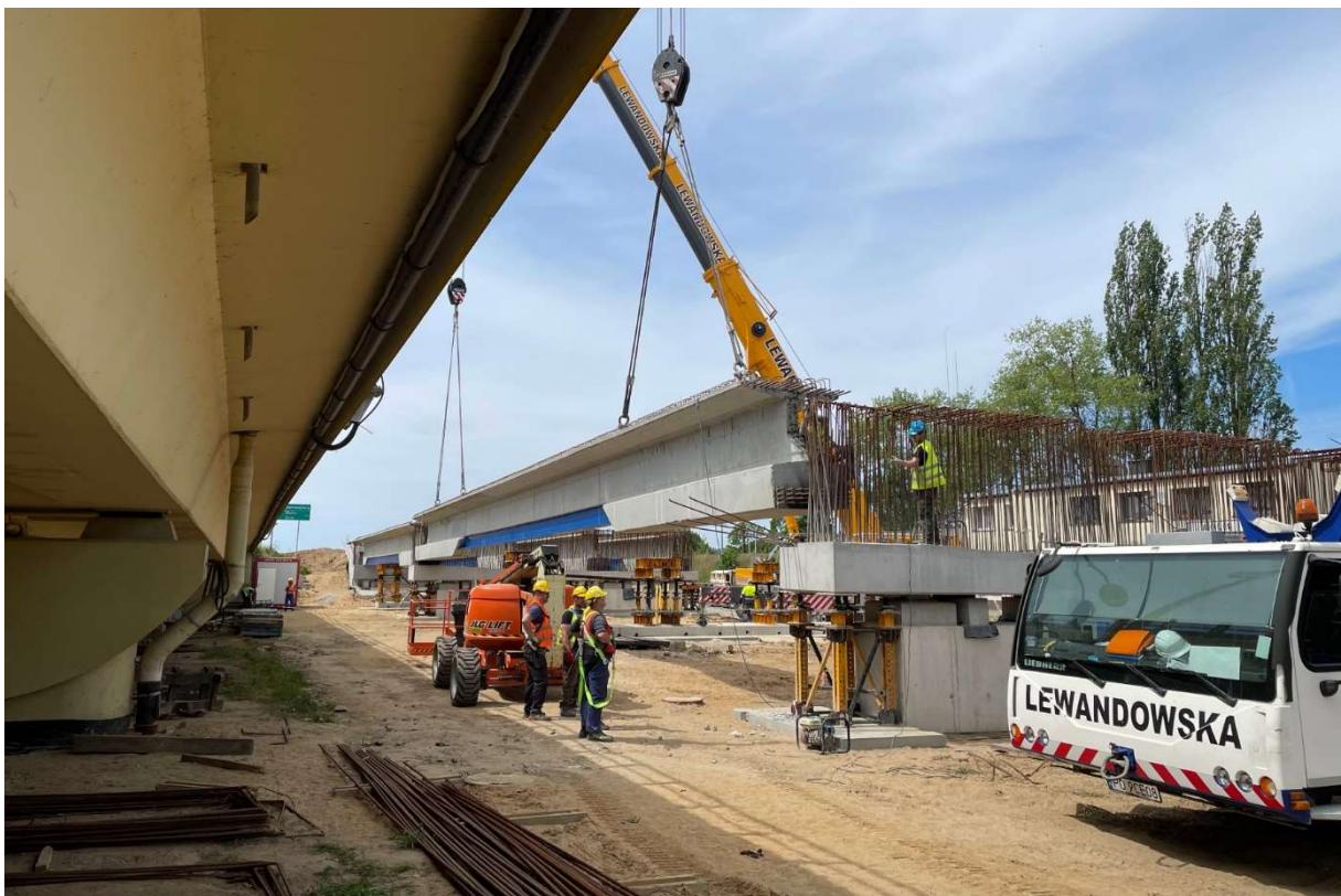
Rys. 28 Montaż belek hybrydowych na moście M-7L (część dojazdowa: 13 przęseł mostu w formie belki ciągłej uramowanej na 3 wewnętrznych filarach)
