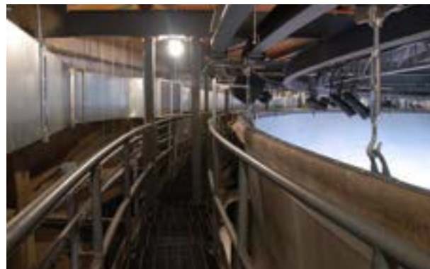
62. Fragment górnej części obrazu cykloramy Bitwa pod Gettysburgiem , widoczne detale systemu zawieszenia obrazu panoramy, szyny nośne i „karnisz” (górną belką nośną obrazu), 2008 rok. Fot. Ryszard Wójtowicz
