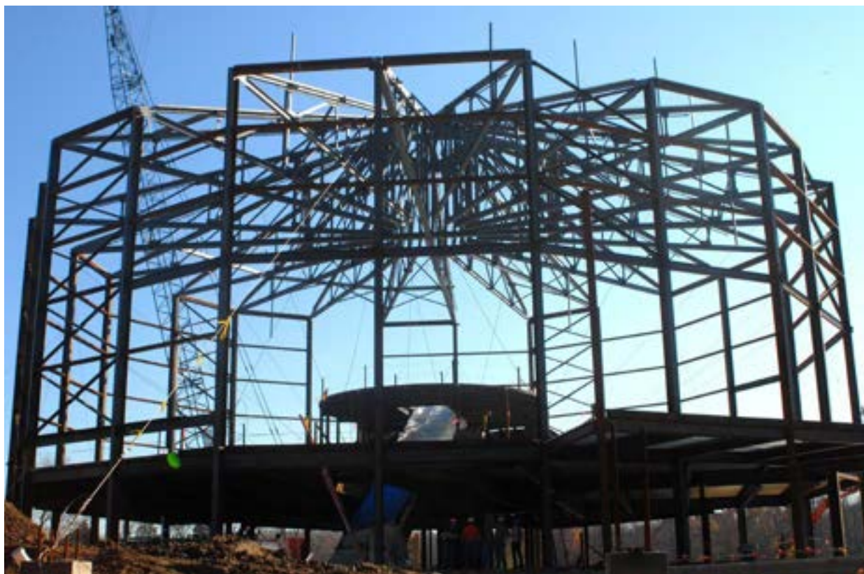
261. Stalowy szkielet nowego budynku rotundy cykloramy Bitwa pod Gettysburgiem na terenie zespołu muzealnego w Gettysburgu, Gettysburg, 2006 rok. Fot. Ryszard Wójtowicz
