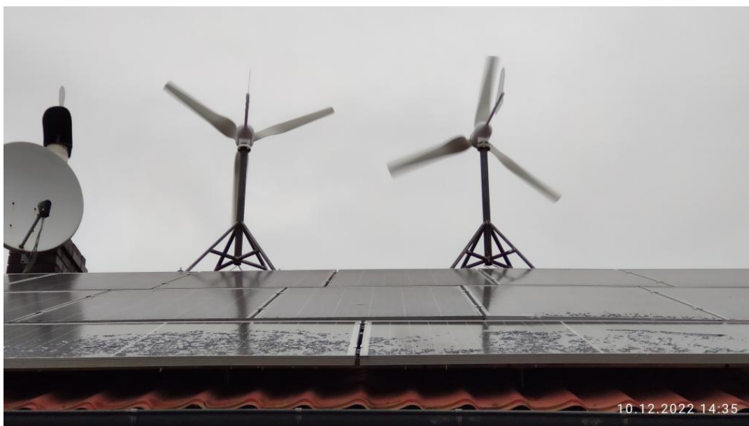
Rys. 7.3. Instalacja turbin wiatrowych wchodzących w skład hybrydowego systemu zasilania [60]
