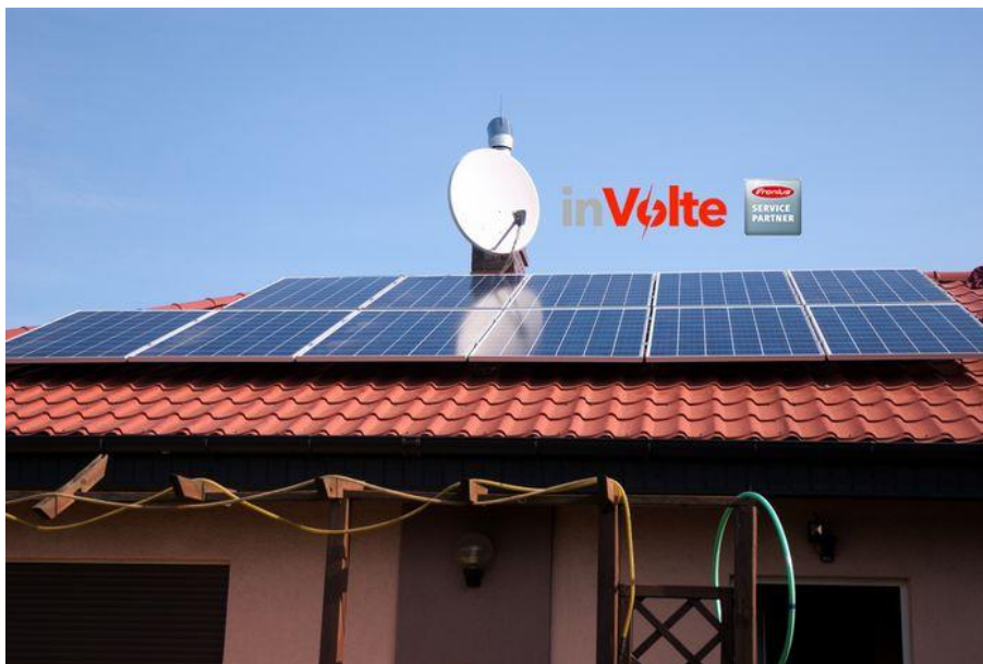
Rys. 7.1. Instalacja fotowoltaiczna wchodzącą w skład hybrydowego systemu zasilania [60]
