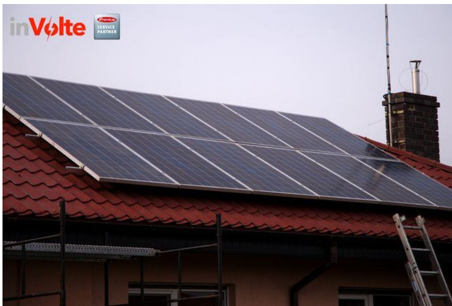
Rys. 7.2. Instalacja fotowoltaiczna wchodzącą w skład hybrydowego systemu zasilania [60]
